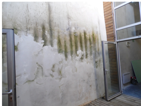
Dans le Patio les traces des infiltrations dans le mur mitoyen sont très visibles
