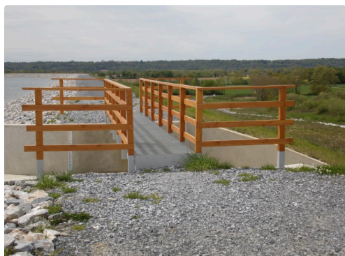
Une rembarde de sécurité en bois sur le passage du déversoir
