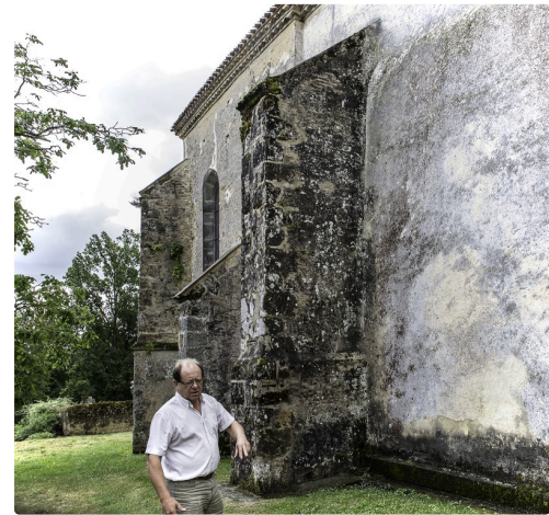
Le maire montre des travaux à faire
