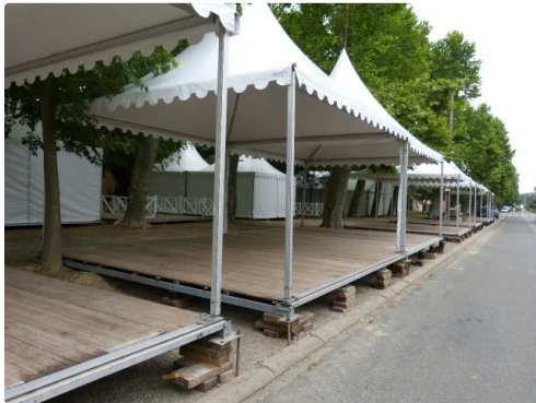
Les installations des allées vont recevoir les restaurateurs
