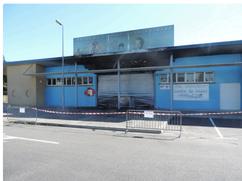
Une entrée détruite par les flammes
