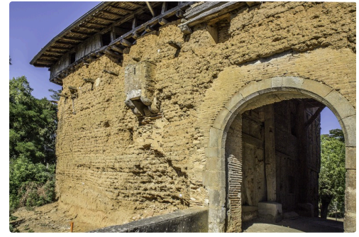
Le Castet et son mur de terre exceptionnel
