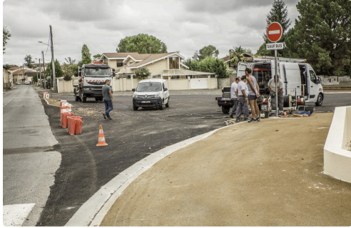
Arrivée à Nogaro depuis Riscle ; des travaux d'éclairage public sont en cours
