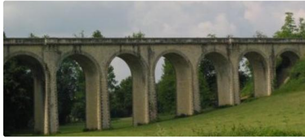
CASTIN : Interdiction de circulation d'engins motorisés sur le viaduc et le tunnel ferroviaire
