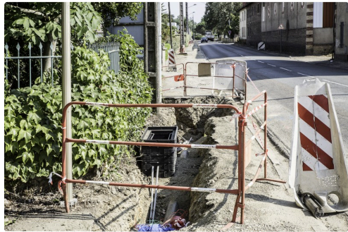
Mercredi 21 juin à heures ces éléments de tranchée avenue des Pyrénées n'étaient pas rebouchés
