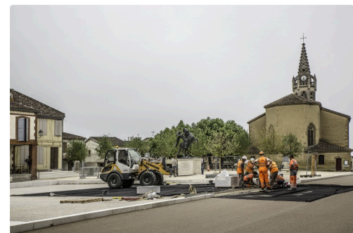
Pendant ce temps, on se hâte d’effectuer les derniers travaux d’aménagement de la place
