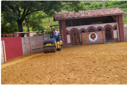
La piste de "l'arène" a été réalisée par une entreprise spécialisée Photos Marcel Lavedan Droits Réservés
