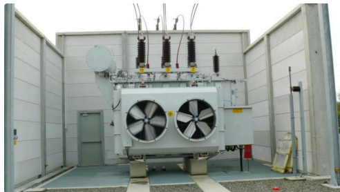
Le 19ème poste source du département, un énorme transformateur électrique.
