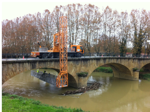
L'étanchéité du pont avait été étudiée par les services de l'état
