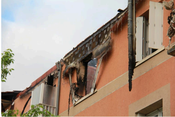
feu d'appartement au 4 eme étage d'un immeuble
