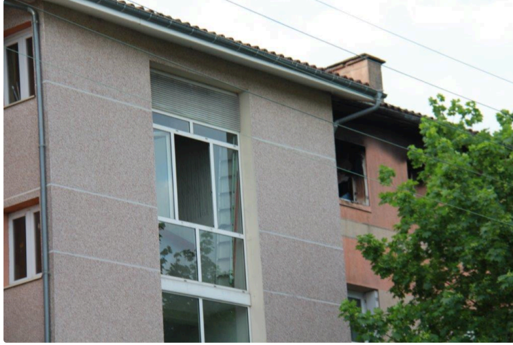
suites incendie appartement avenue Claude Augé
