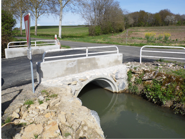
La circulation était interdite depuis plus d'un an
