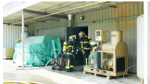
Intervention des sapeurs pompiers pour effectuer le relevé de monoxyde de carbone.
