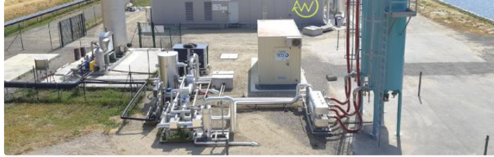
Inauguration de la 1ère unité de production de biométhane d'Occitanie
