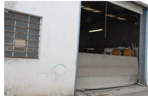
Porte de l'entrepôt.
