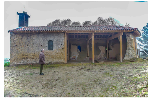
La chapelle de Daunian en cours de rénovation ; au 1er plan, le maire, Jean Duclavé
