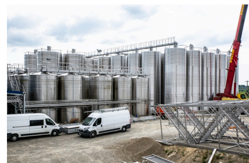
Les nouvelles cuves, à droite
