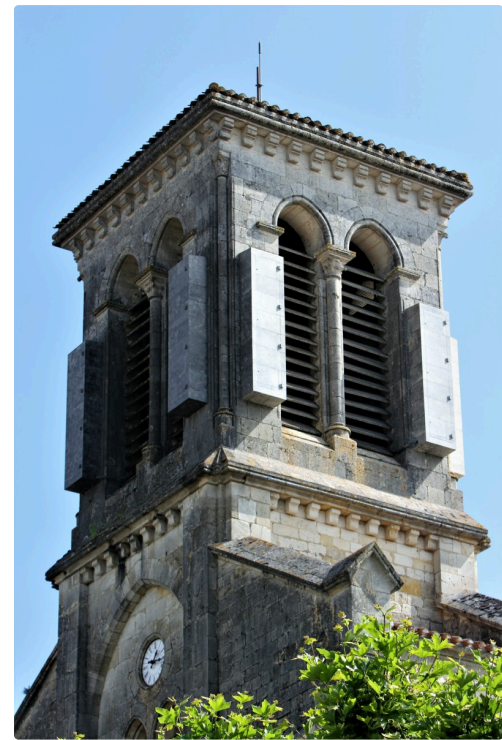
Les coffres renfermant les antennes relais sont plus gros que ce que pensaient le maire et ses administrés.
