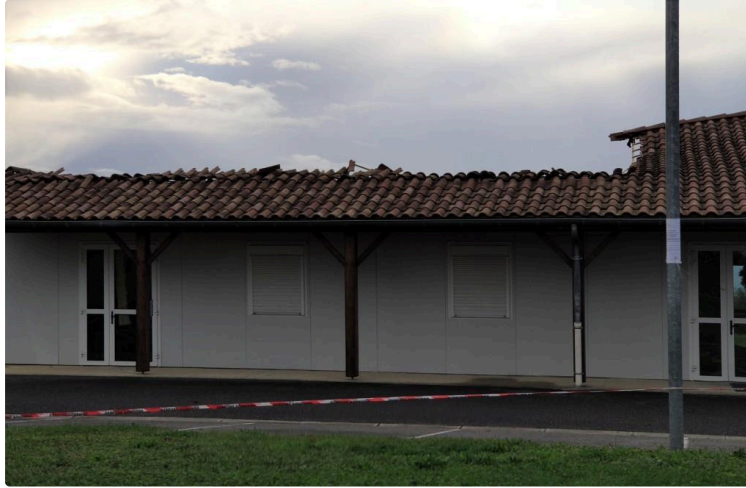
Le toit de la salle des associations s'effondre
