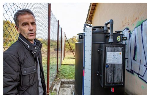
Le redresseur de pH traite l'eau avant sa consommation
