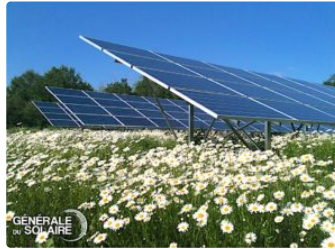
Un financement participatif pour une centrale solaire au sud de Toulouse
