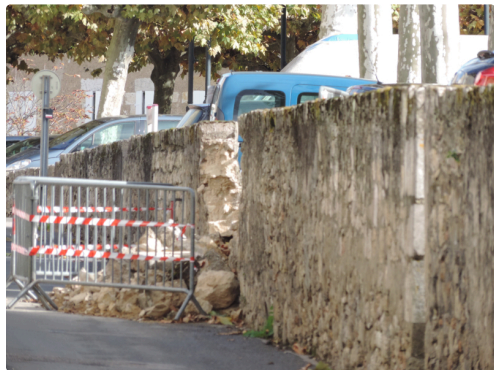
L'urgence des travaux est une réalité
