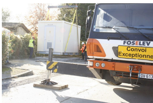
Shelter installé par Gers Numérique à Villecomtal sur Arros en 2018.
