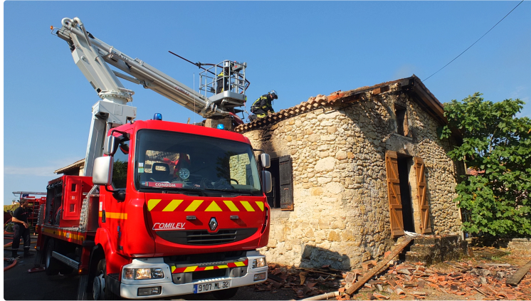
Une maison détruite par le feu
