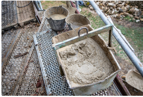
Bac à chaux
