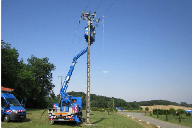
ENEDIS modernise son réseau électrique
