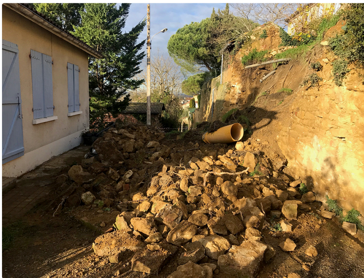
Violent incendie au Garros à Auch. Montesquiou, effondrement d'un mur de soutènement.
