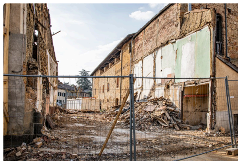
Maison détruite à droite des étais (côté rue des Pénitents)
