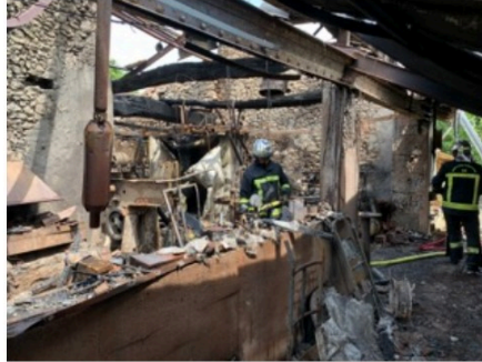
Des dépendances détruites par un incendie à Saint-Paul de Baïse
