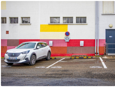
Parking dédié au branchement électrique chez HDM avec 2 bornes
