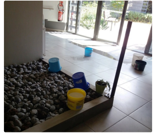
de multiples infiltrations dans l'établissement ©chantal Bassi
