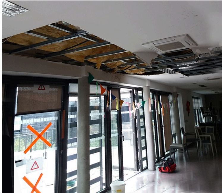
Tempête : l'EHPAD particulièrement touché
