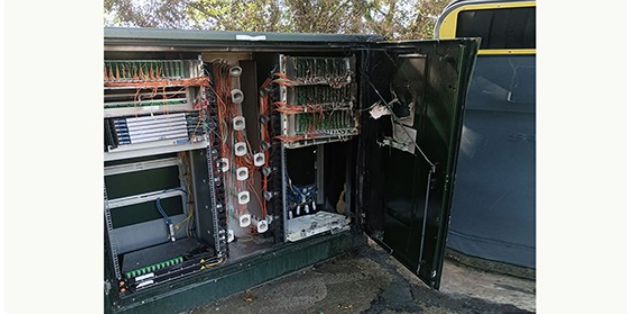
Privés de ligne internet suite à un incendie
