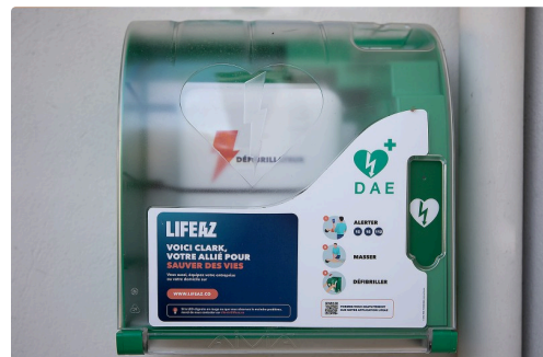
Le défibrillateur fermé, en place sur le mur extérieur du foyer
