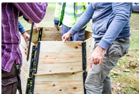
Un composteur presque terminé
