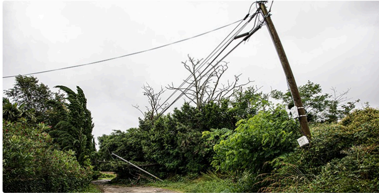
Les lignes électriques victimes des coups de vent
