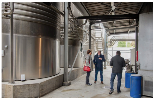
Au pied des cuves extérieures
