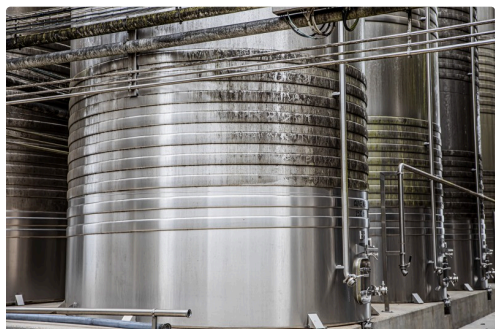
Noter les cercles de refroidissement sur les cuves situées à l'extérieur
