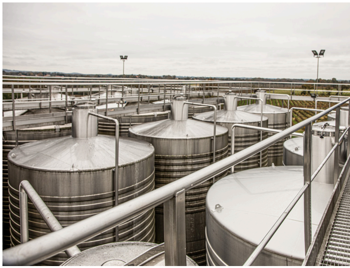
Tout en haut des cuves
