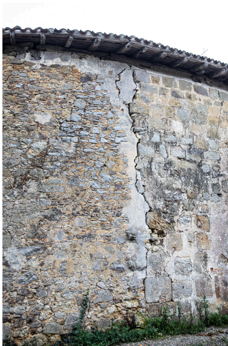
Fissure à l'extérieur
