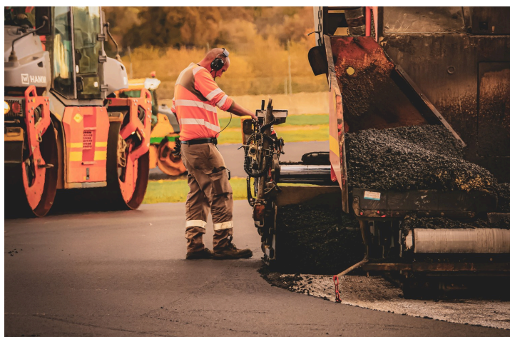
Le circuit pendant les travaux (photo Real Drone Inspection communiquée par le circuit)
