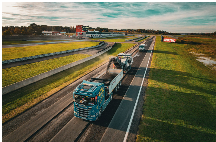
Le circuit pendant les travaux (photo Real Drone Inspection communiquée par le circuit)
