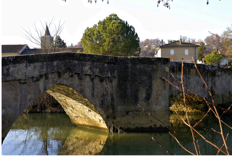
Le vieux pont de Pavie dégradé accidentellement fermé à la circulation
