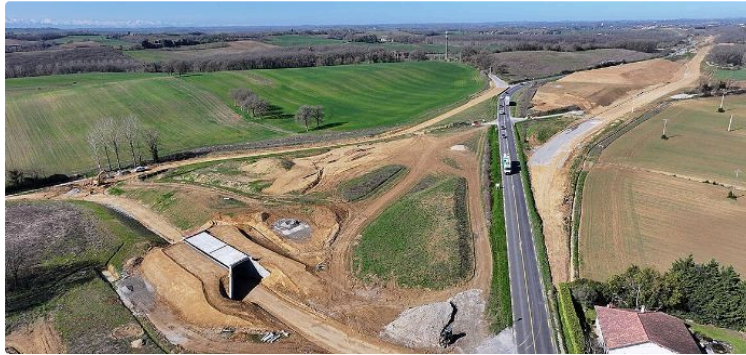
Circulation : Réouverture de la N124 entre L'Isle-Jourdain et Gimont à 12 heures ce vendredi
