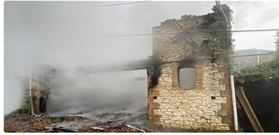
Incendie d'une remise de stockage
