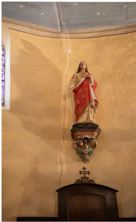
Fissure vue de l'intérieur
