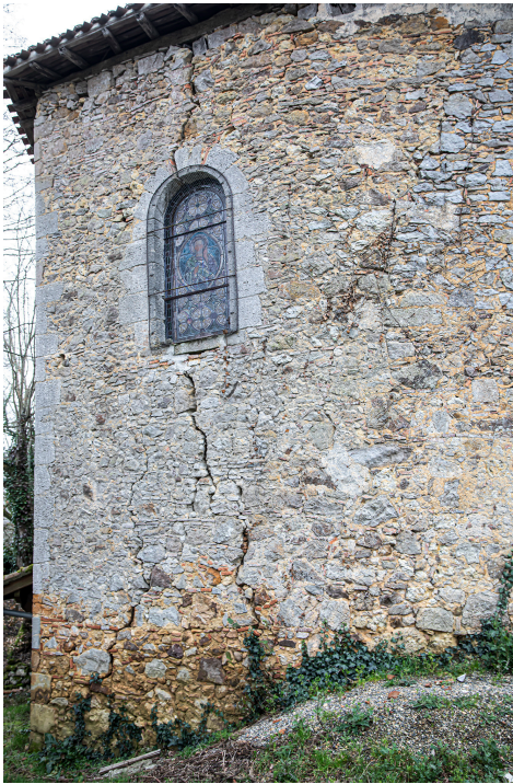
Fissure vue de l'extérieur
