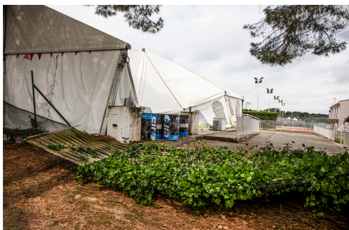
Au 1er plan, la clôture du stade est renversée ; en arrière plan, le chapiteau a souffert
