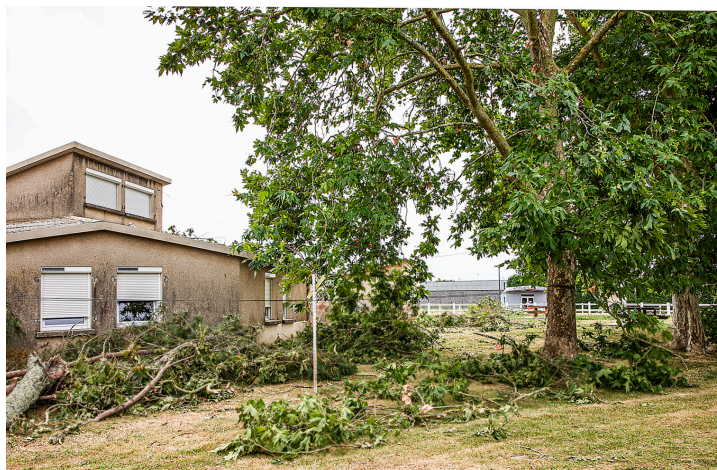
Dégâts sur l'arrière du gîte d'étape
