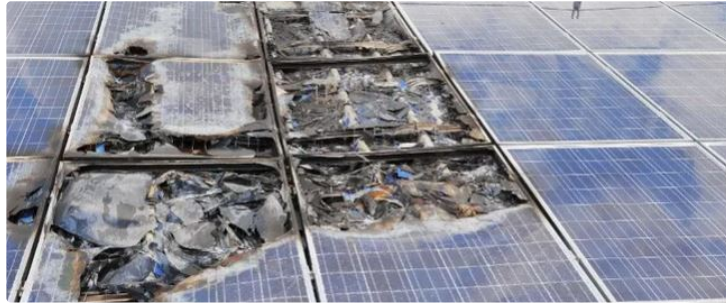
Des panneaux photovoltaïques en feu sur le toit d'une maison d'habitation
