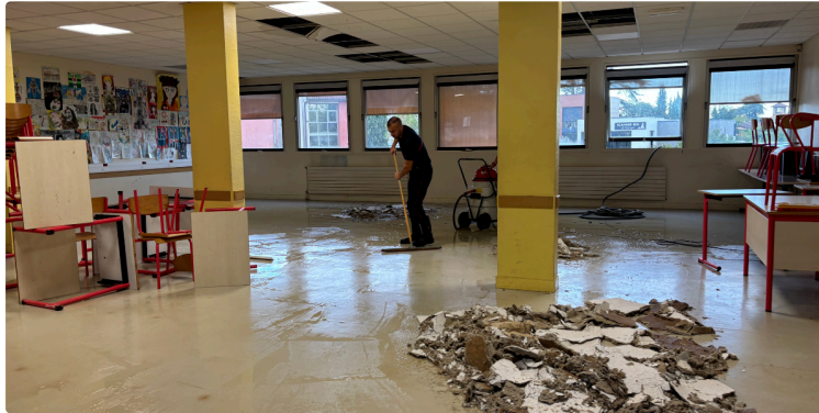
Rupture d'une canalisation au collège Carnot : sécurité assurée et continuité des cours garantie
