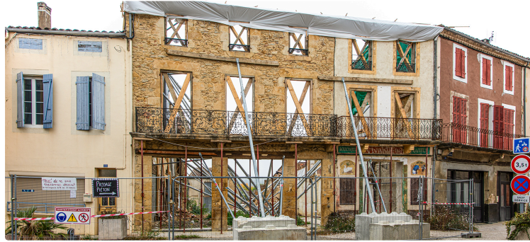
Aignan : à quand les travaux de réfection du bâtiment effondré sur la place ?
